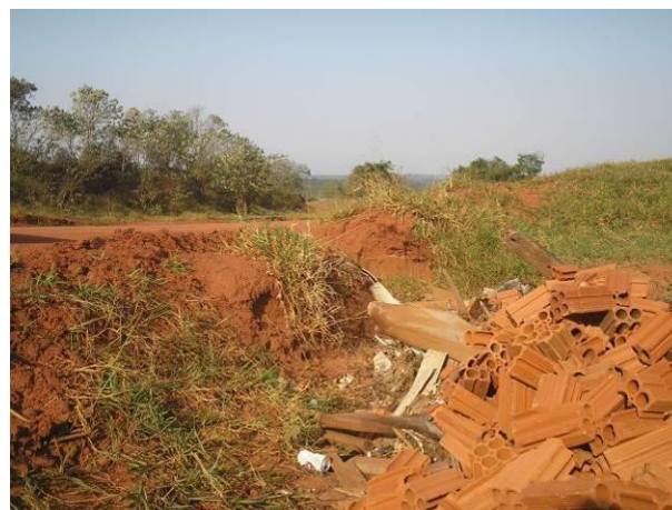
Figura 4 – Depósito irregular de RCD em área erosiva de Tuneiras do Oeste/PR
