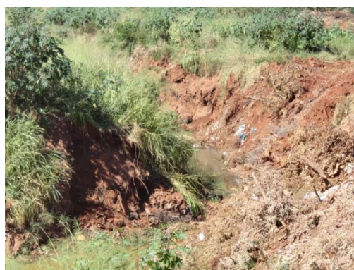
Figura 4: leito do Córrego, recomposição das margens através de resíduos sólidos Fonte: GONÇALVES e GONÇALVES 2013
