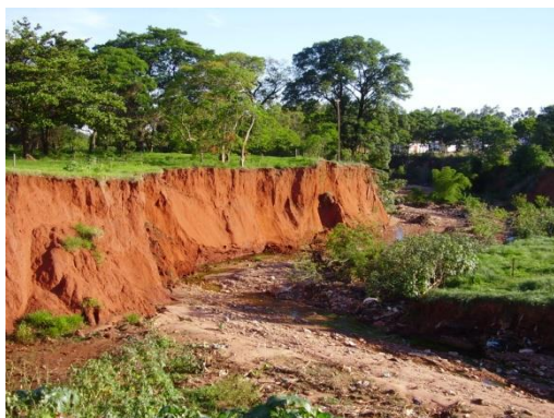
Figura 1: leito do Córrego Manolo Baracá, destaque à erosão da margem e sedimentação do leito Fonte: GONÇALVES, 2006
