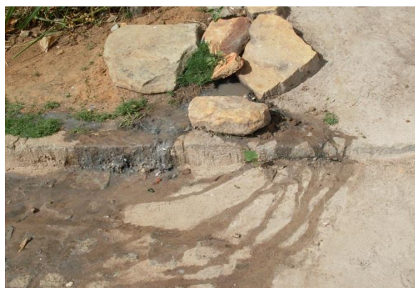
Figura 7. Esgoto a céu aberto por um cano protegido com pequenas rochas
