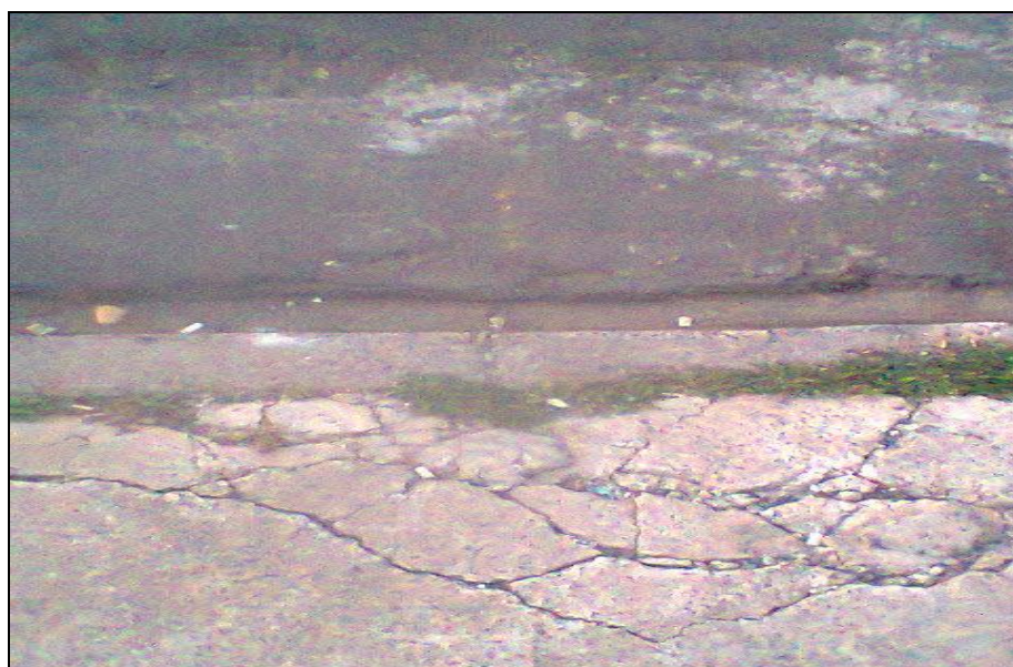
Figura 4 – rachaduras em calçamento do conjunto habitacional Fonte: LANGARO, Sonia Vanessa; BOBATO, Zaqueu Luiz (2013)
